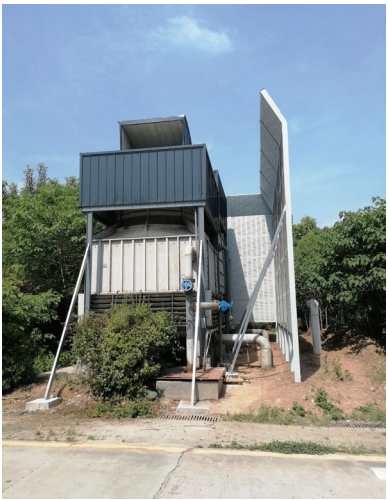
冷却塔隔音屏障
