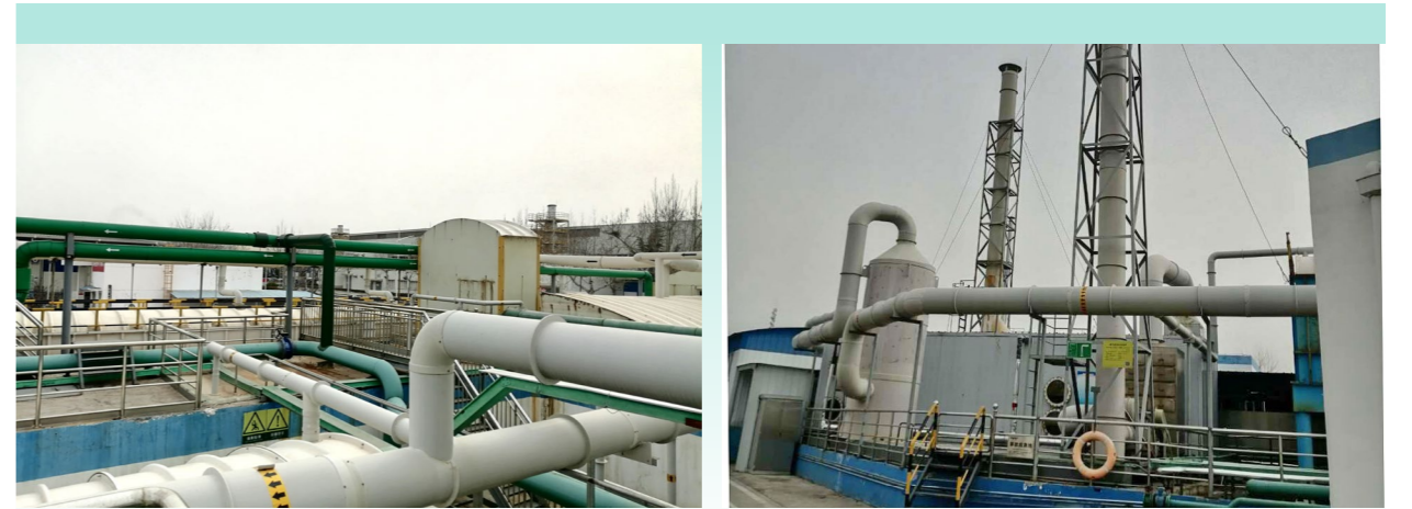
对高新区污水站恶臭气体进行收集和治理，确保污水站无恶臭气体逸散
