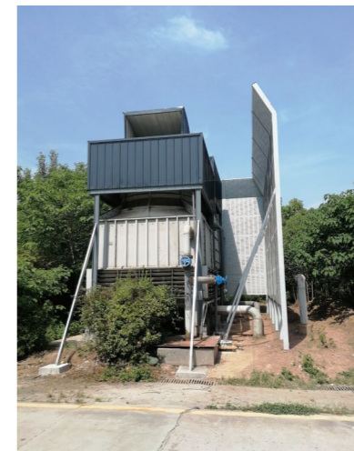
冷却塔隔音屏障
