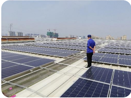
光伏发电系统
